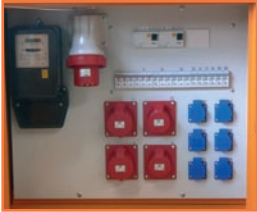
Gut zugänglicher und praxiserweiterter Steckdosenbereich, Einspeisung über CEE-Gerätestecker
